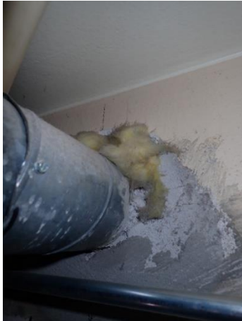
Kuva 23. Lasketun katon yläpuolella havaittiin epätiivitä läpivientejä, joiden kautta kulkeutuu hajuja ulkovarastosta koulun käytävätilaan. Kuva luokan 1005 edustalta käytävästä.
