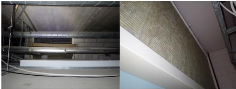
Kuva 22. Väliovien yläpuolella on levyttämätöntä mineraalivillalevyä, joka on paikoin pois paikoiltaan. Tilat ovat ilmayhteydessä toisiinsa. Kuva liikuntasalisiiven porrasaulasta ja ruokalan käytävältä.
