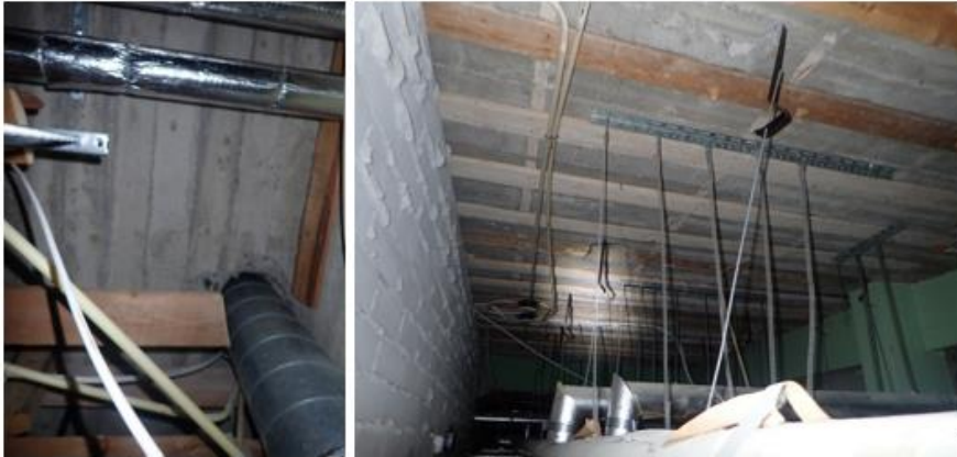
Kuva 32. Yläpohjassa tiivistämättömiä läpivientejä ja muottimateriaalia, päärakennuksen - 59 osa
