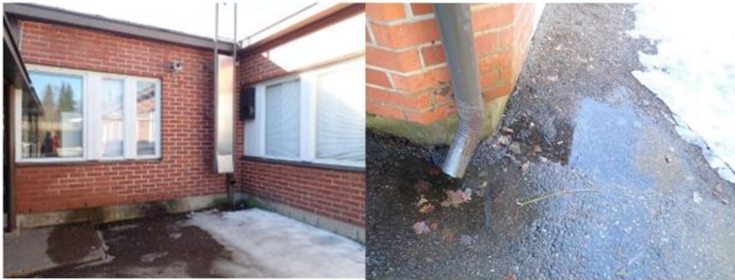
Kuva 40. Päärakennus, -81 osa, julkisivua. Sadevesijärjestelmä ohjaa vettä ulkoseinän lähelle useammassa kohtaa. Vesikourujen kallistukset eivät ole riittäviä tai kouruissa on reikiä, koska vettä tippuu väärästä kohtaa.
