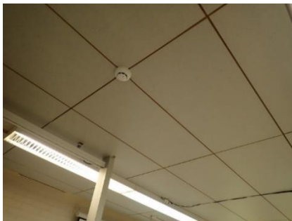
Kuva 21. Luokkatilojen katossa akustiikkalevyissä on päällystämättömät reunat, joista voi irrota sisäilmaan mineraalikuituja.
