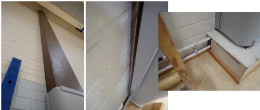
Kuva 16. Liikuntasalissa elastisia saumauksia pilarien sivuilla on paikoin massattu. Pilarien alaosissa ja puulattian alla ei havaintojen mukaan ole massausta tehty.
