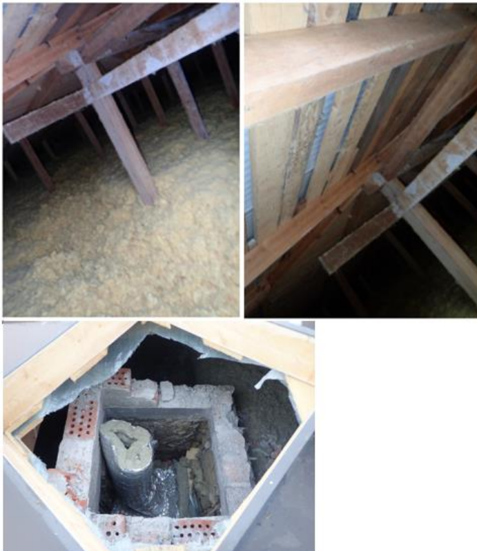
Kuva 34. Päärakennus, -81 ullakolla ei ole kulkusiltoja. Rakennusjätettä hormissa.
