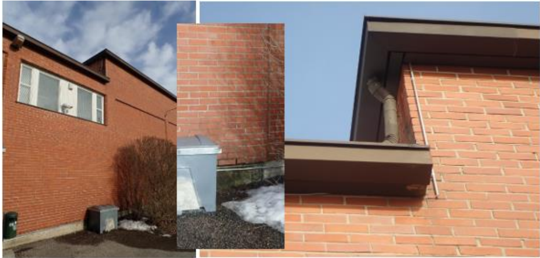
Kuva 12. Ylemmän vesikaton sadevedet johdetaan alemmalle vesikatolle, josta osa vedestä valuu rakennuksen ulkoseinää pitkin kastellen rakennetta. Pensaat on istutettu lähelle rakennusta ja lisäävät rakenteisin kohdistuvaa kosteusrasitusta.
