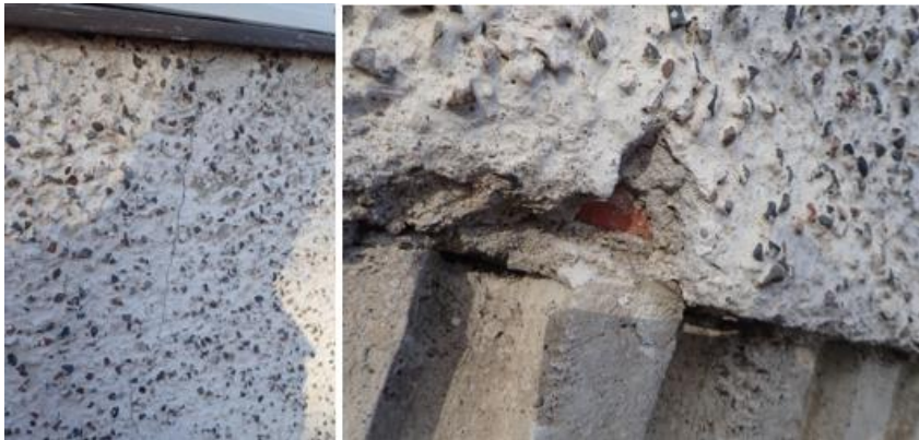
Kuva 38. Lisärakennus -59, ulkoseinien rappauksessa on korjaustarpeita
