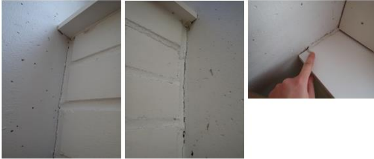
Kuva 15. Ruokalan ikkunalautoja on uusittu. Ulkoseinien ja kantavien rakenteiden liittymissä on halkeamia, joiden kautta ilmavirtaukset rakenteesta sisäilmaan ovat mahdollisia.
