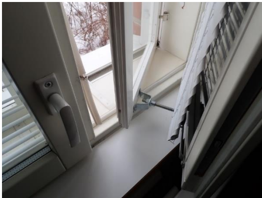
Kuva 45. Päärakennus v. 2002, ikkunoissa on pieniä huoltotarpeita kuten tiivisteet, A26.
