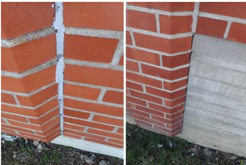
Kuva 41. Päärakennus, -81 osa. Julkisivua. Pystysaumuksissa on rakoja ja halkeamia.
