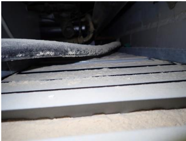
Kuva 24. Liikuntasalin viereisessä käytävässä lasketun katon yläpuolella havaittiin puruja ja pölyä, joita kulkeutuu sinne yläpuolisista teknisen työn tiloista.
