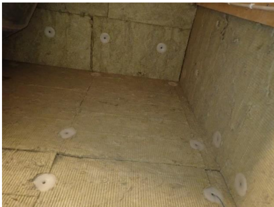
Kuva 25. Ilmanvaihdon konehuoneissa on seinillä mineraalivillapintoja, kuitulähteitä.
