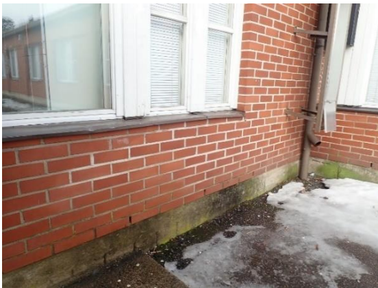
Kuva 13. Ruokalan ulkoseinän näytteessä todettiin viite vauriosta.
