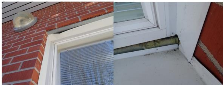
Kuva 46. Päärakennus, -02 osalla ikkunoiden pellitykset ovat irronneet.
