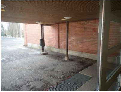
Kuva 17. Liikuntasalin maanvastaista seinää rasittaa ylempää piha-alueelta ja räystäältä peräisin oleva kosteus. Sokkeleissa havaittiin sammaloitumista. Samalla kohtaa alapuolella rakenneavauksessa aistittiin mikrobiperäinen haju (RA17).
