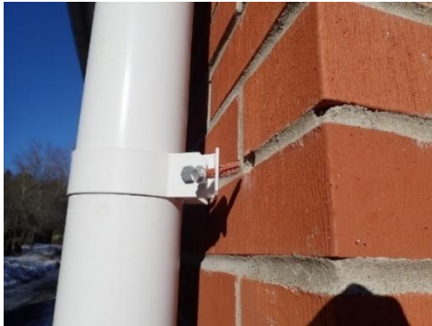
Kuva 47. Syöksytorven kiinnikkeet ovat irronneet seinästä, päärakennus -02 osa.
