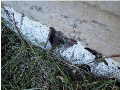
Kuva 42. Sisäpihalla havaittiin pienellä matkalla lämmöneriste sokkelin ulkopinnassa.
