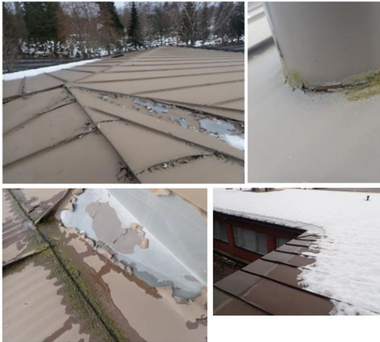
Kuva 33. Päärakennus, -81 vesikatto kaipaa huoltokorjausta.
