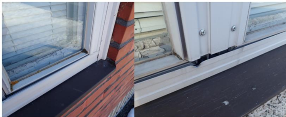
Kuva 39. Puuikkunoihin on lisätty lisälasi. Listoitusten liittymissä on rakoja.
